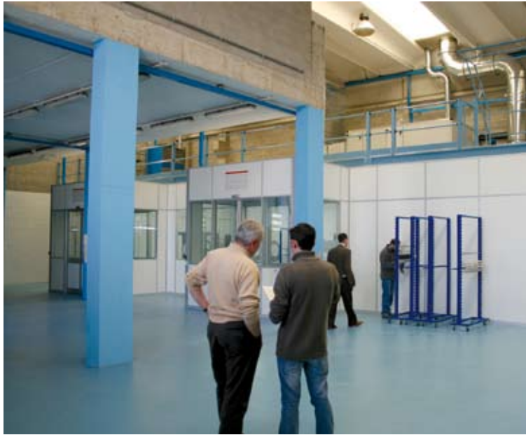
3 – La instalación de acabado “metalorgánico” de piezas de metal y plástico instalado en la planta de Sunagen.
